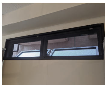
▲定期的な換気(窓/ドア全4箇所を開放)
